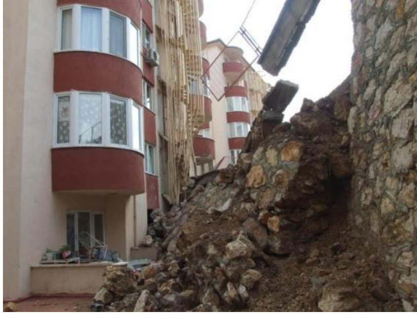
Şekil 1. Kahramanmaraş' ta Yıkılan İstinat Duvarı
