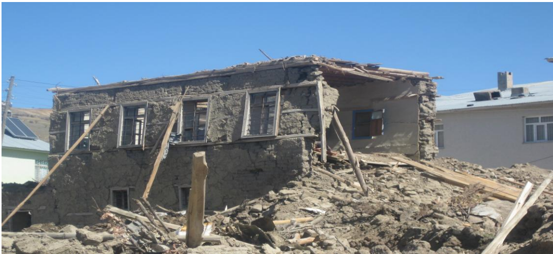
řekil 4. Depremden Sonra Okular Kynde Yıkılan Kerpi Yapı
