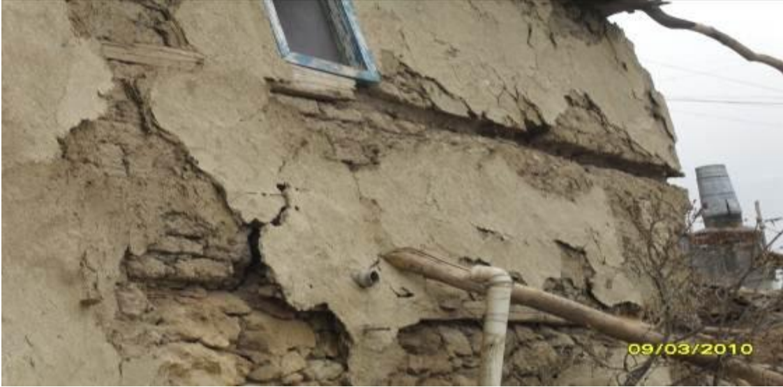
Şekil 6. Depremden Sonra Bayramyazı Köyünde Hasar Gören Kerpiç Yapı
