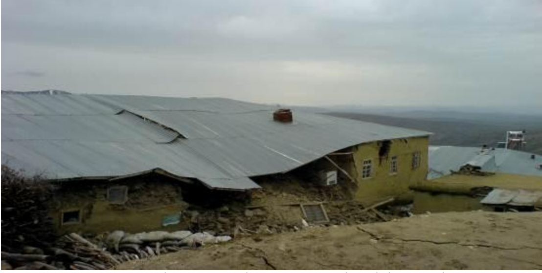
Şekil 5. Depremden Sonra Yalnızçam Köyünde Yıkılan Kerpiç Yapı
