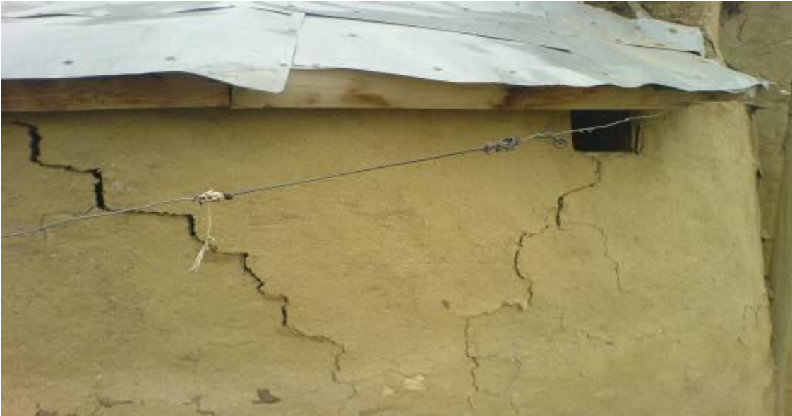
Şekil 7. Depremden Sonra Tabanözü Köyünde Hasar Gören Kerpiç Yapı
