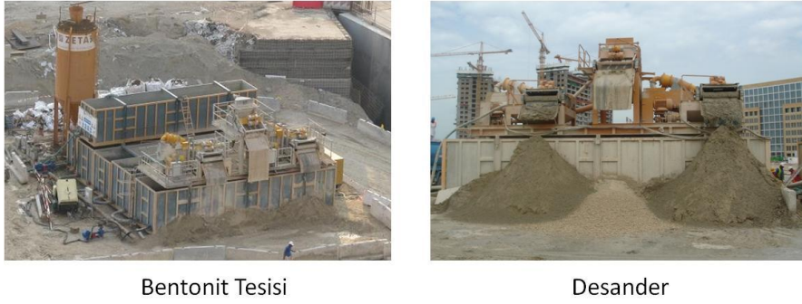
Şekil 12C. Bentonit Tesisi ve Desander
