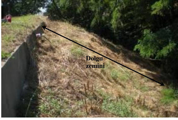
a) Dolgu etkisine maruz depo dış duvarı
