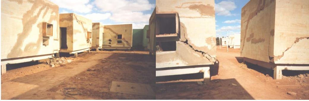
Şekil 5. Şişen Zeminin Yapılarda Neden Olduğu Hasar (Solda) ve Zeminin Şişme Etkisiyle Yukarı Doğru Bükülmesi (Sağda) (Derriche and Iguechtal)
