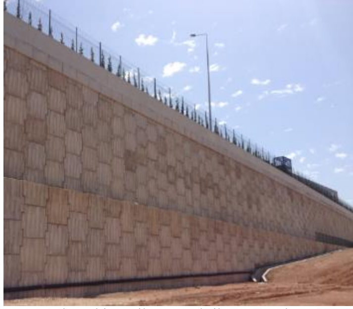
Şekil 10. Rozak Makina Dilovası Fabrikası Toprakarme Duvarı [8]
