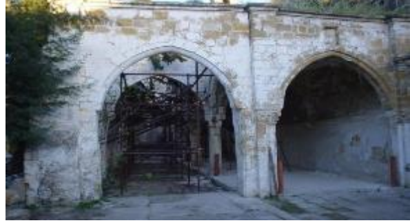
Şekil 2. Bedesten (tarihi bina) hasarı
