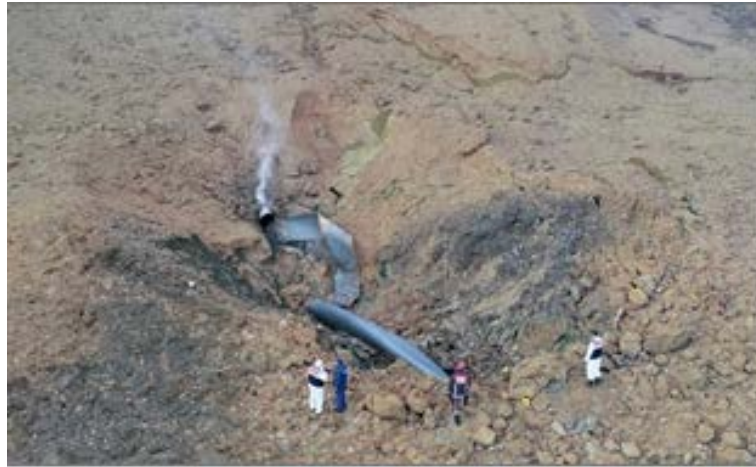
Şekil 1. Doğalgaz Boru Hattı Patlaması (Url-1)
