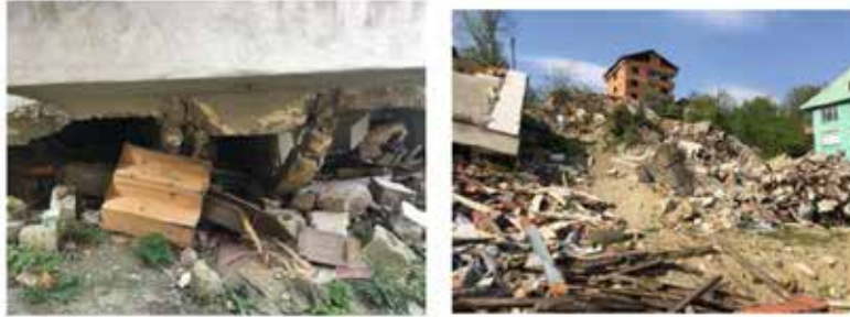
Şekil 3. Heyelanın hasar verdiği yapılar- Karşıyaka mahallesi
