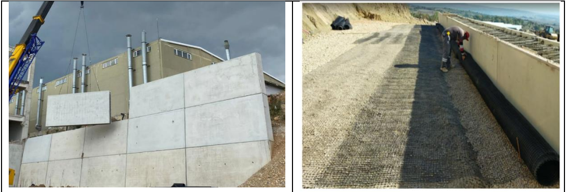
Şekil 5. Ada Koltuk projesinde prefabrik Double Wall duvar modülleri ve geogrid uygulaması, (Özçelik vd., 2022)
