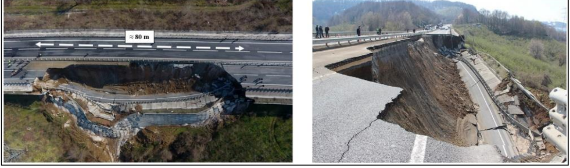
Şekil 1. Göçen Duvar Hattı (Kuzey-Güney / Doğu-Batı)
